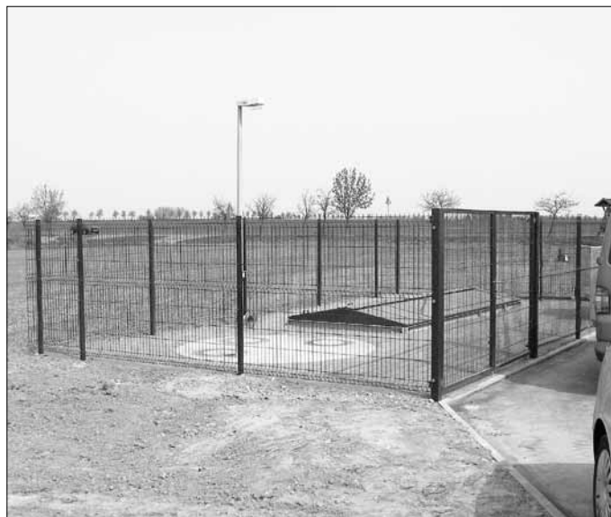
Die neue Gruppenkläranlage GKA in Neudorf
